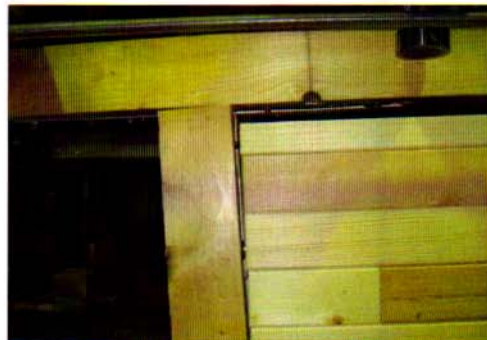
写真 13 試験終了後の様子(No.3) 左柱頭部の様子
