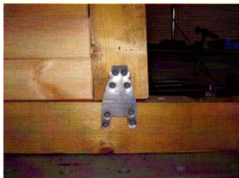
写真 15 試験終了後の様子(No.4) 右柱脚部の様子
